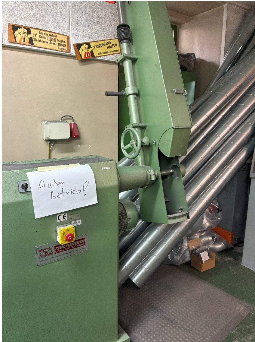
Abbildung 4: Außer Betrieb stehende Geräte
