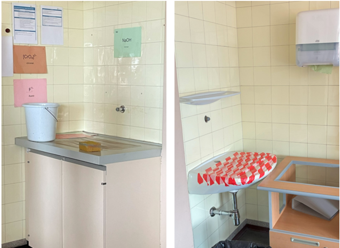
Abbildung 3: Stillgelegte Waschbecken in Klassenräumen
